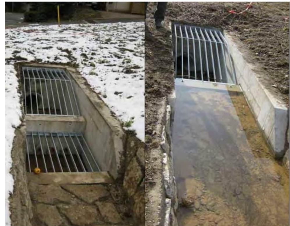
Einlaufbauwerk mit Schlamm- und Geröllfang vor und nach Starkregen
